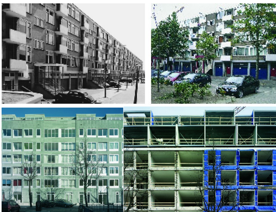
Immagini relative alla situazione originaria e alle fasi di intervento (fonte Renovatie woongebouw De Leeuwan Vlandern Amsterdam, Bouwen met Staal 2006 )
