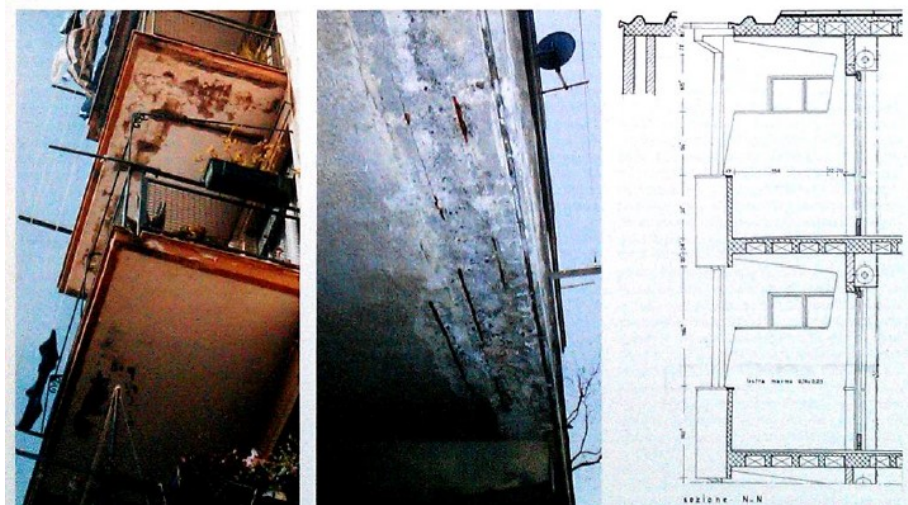
Tipologie di degrado e patologie (fonte lezioni online di Marina Montuori, Barbara Angi, Massimiliano Botti, Università degli Studi di Brescia, Dipartimento DICATAM)
