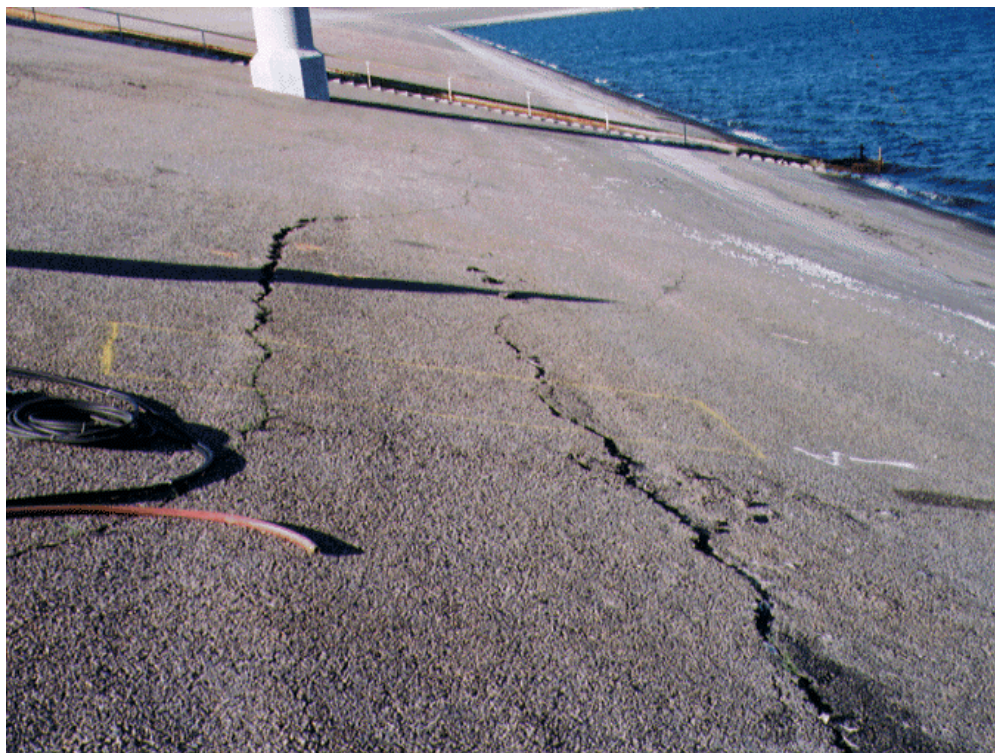
Fig. III.7 – Lesioni sul paramento di monte della Los Angeles Dam a seguito del terremoto di Northridge del 1994 (USGS).
