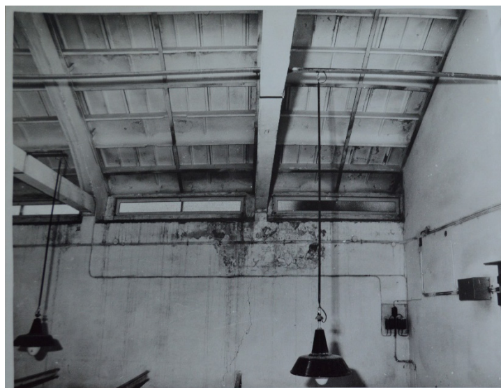
Fig. 4.67- Il degrado delle strutture di copertura, particolare del tetto al di sopra dei velari, 1982, Fototeca di Castel Sant'Elmo, Polo Museale della Campania, (negativo A.F.S.B.A.S. – n. 12249 M.).
