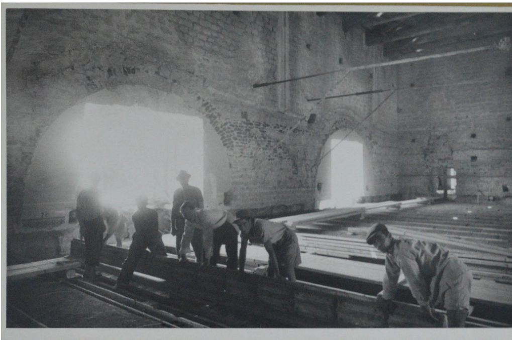
Fig. 4.42- Lavori nell'ex Sala dell'Armeria 1952, Fototeca di Castel Sant'Elmo, Polo Museale della Campania, (negativo A.F.S.B.A.S. – n. 405 DOC).
