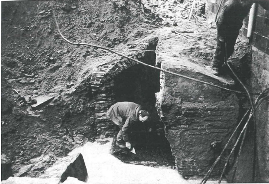
Fig. 3.39- I lavori di scavo della corte. Uno degli ambienti voltati prima della demolizione, 1982. Foto R.G.D.- Agenzia per gli edifici governativi
