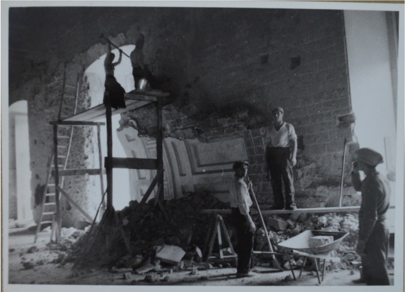
Fig. 4.46- Cappella Reale, lavori di demolizione, 1951-52, Fototeca di Castel Sant'Elmo, Polo Museale della Campania, (negativo A.F.S.B.A.S. – n. 1713 DOC).
