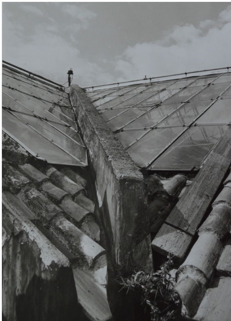
Fig. 4.66- Il degrado delle strutture di copertura, 1978, Fototeca di Castel Sant'Elmo, Polo Museale della Campania, (negativo A.F.S.G. – n. 3272 M- 7 ott. 1978).
