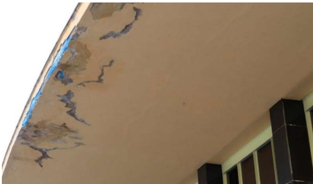
Figura 199- Palazzo delle Poste, M. Ridolfi. Degrado della pensilina in calcestruzzo armato intonacata del prospetto principale su Piazza Bologna; si noti l'intervento con passivante sui ferri d'armatura ossidati a causa dei problemi scaturiti dall'insufficiente sistema di regimentazione delle acque meteoriche. Foto di S. Iaccarino, Roma, Maggio 2021.
