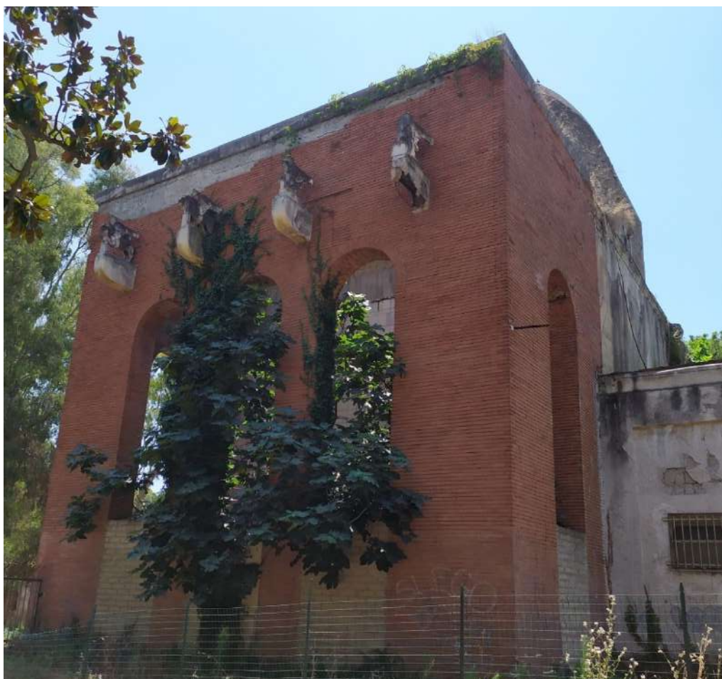
Figura 202- Effetti dell'azione dell'acqua meteorica sul coronamento della Chiesa di S. Maria Cabrini, nella Mostra d'Oltremare a Napoli. Si evidenzia l'espulsione della cortina in laterizio conseguente all'ammaloramento della malta cementizia di allettamento, il cui stato conservativo è ulteriormente danneggiato dalla presenza di vegetazione infestante. Foto di S. Iaccarino, Luglio 2020.
