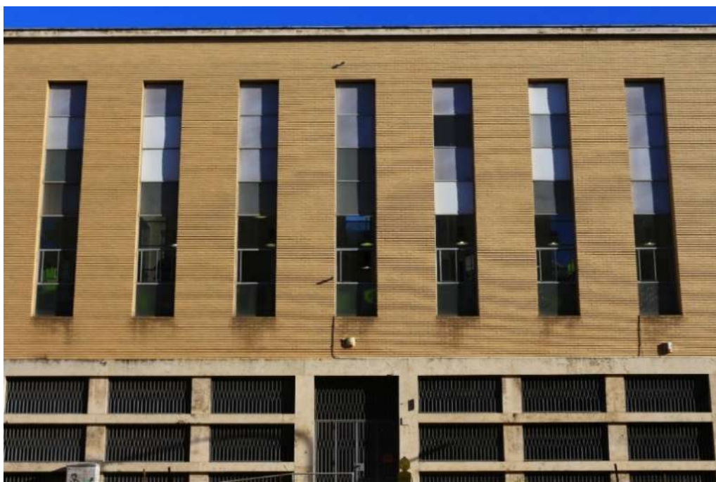
Figura 205- Disomogeneità dei serramenti del prospetto del Palazzo Postale di Saponà su via La Spezia, in cui si alternano senza uno schema omogeneo pannelli lattescenti (forse in Termolux) con pannelli in vetro trasparente. Foto di S. Iaccarino, Maggio 2021.
