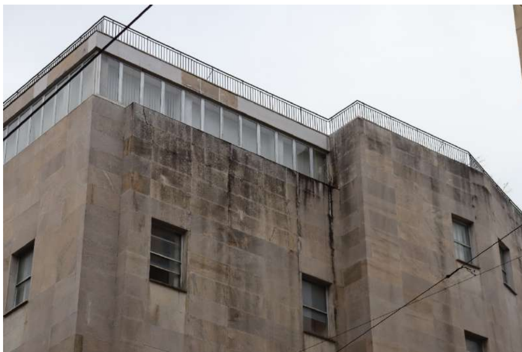
Figura 200-- Dilavamento sul prospetto di via Monteoliveto del Palazzo Postale di Napoli. Si noti il livello di deperimento superficiale che, in alcuni casi, preannuncia (o ha già causato) la fratturazione di alcune lastre. Foto di S. Iaccarino, Novembre 2021.
