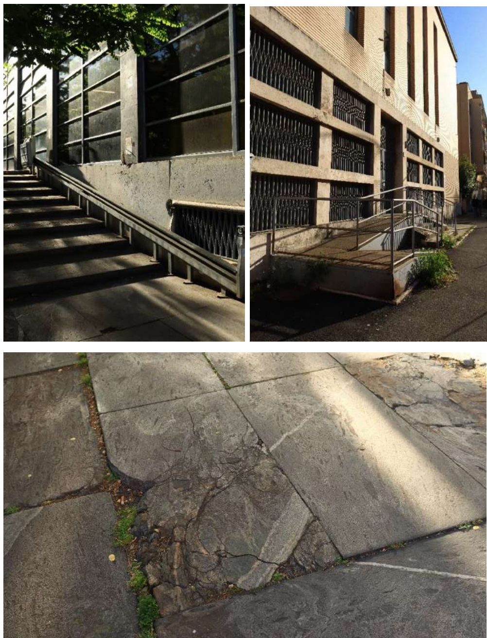
Figura 106- In alto, le risoluzioni per le barriere architettoniche messe in opera nel Palazzo Postale di via Taranto. In basso, le criticità ancora in opera. Foto di S. Iaccarino, maggio 2021.
