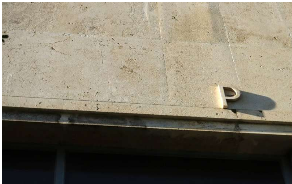
Figura 219- Iscrizione lapidea sul fronte del Palazzo delle Poste e Telegrafi di Via Taranto. Dettaglio delle stuccature seguite alla rimozione della scritta REGIE. In foto, è possibile leggere le tracce della "I" e delle "E". Foto di S. Iaccarino, Maggio 2021.
