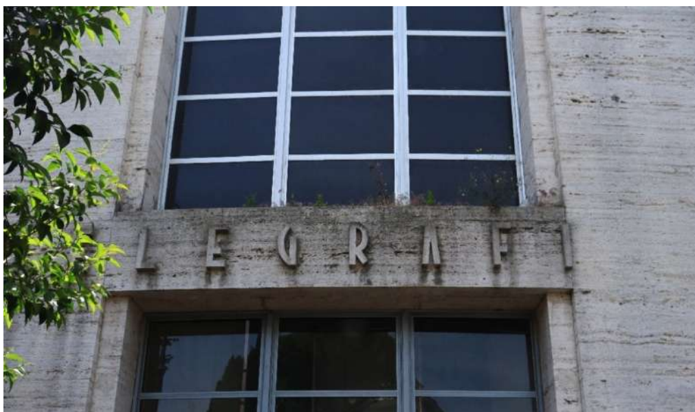
Figura 204- Dettaglio dei nuovi infissi del Palazzo Postale del Quartiere Milvio, in contrasto con la superficie e le iscrizioni in travertino degradate. Foto di S. Iaccarino, Maggio 2021.
