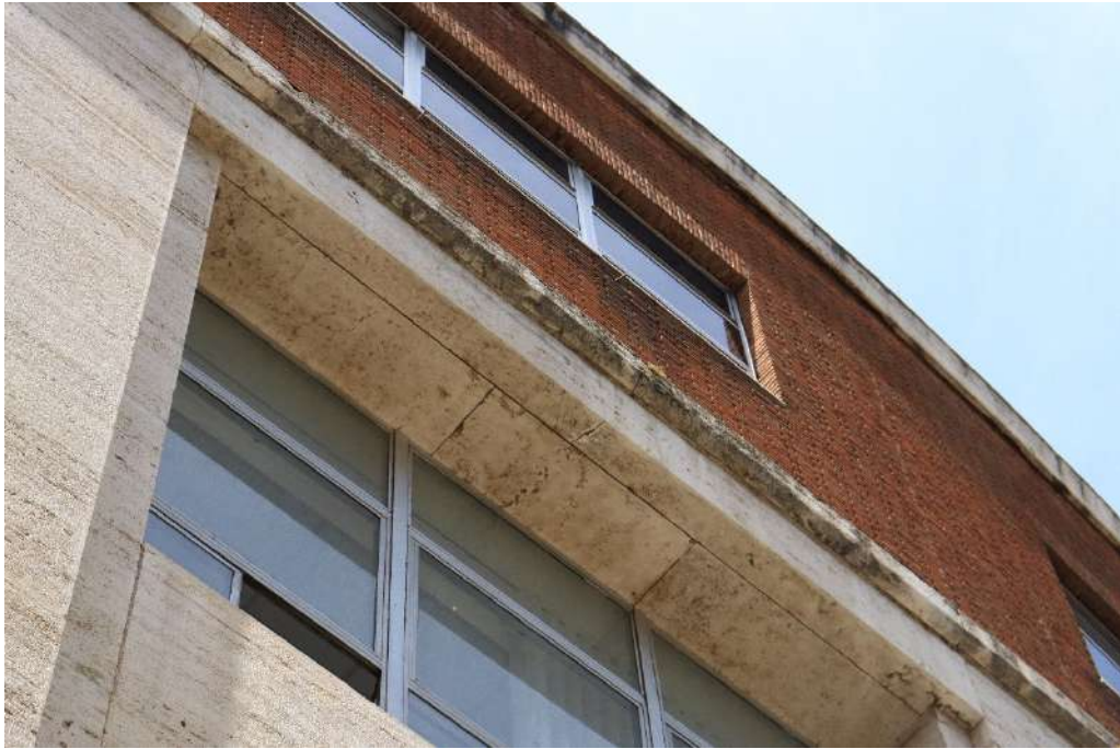
Figura 160- Le cornici e le imbotti in travertino risultano fortemente intaccate da problematiche conservative inerenti le acque meteoriche. Foto di S. Iaccarino, maggio 2021.
