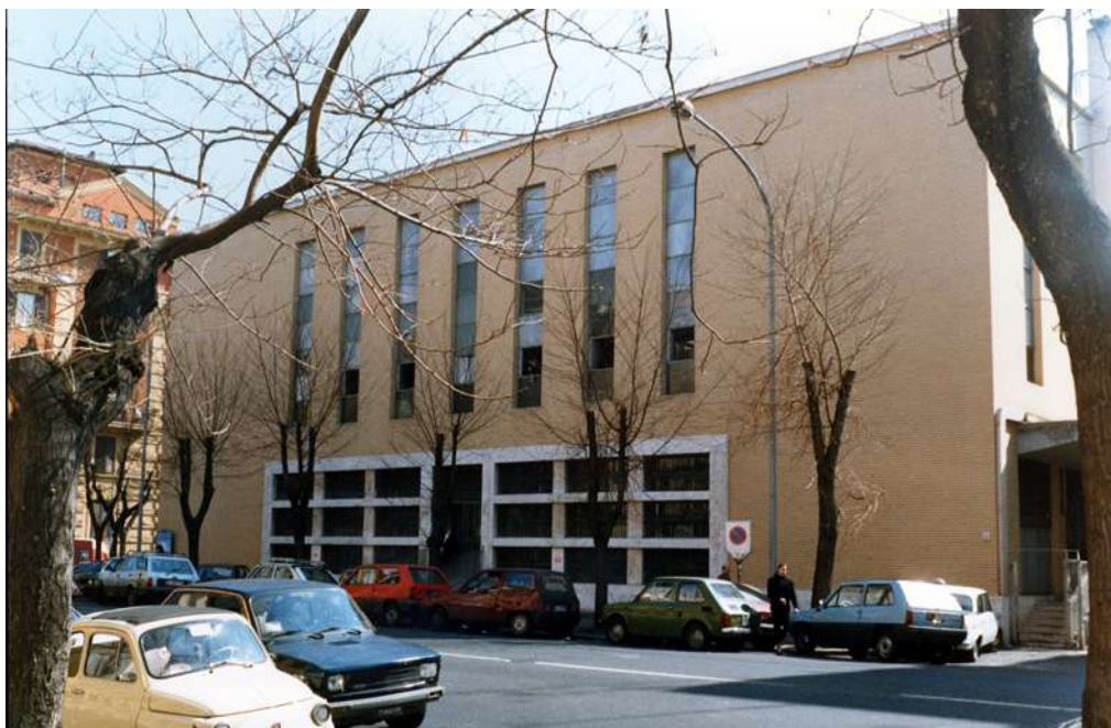
Figura 90- Interventi degli anni Settanta. In alto, i prospetti su Via Taranto e Via Pozzuoli. In essi si evidenzia un forte segno grafico definito dalle stuccature dei giunti appena ripristinate, decisamente più chiare del rivestimento in travertino. In basso, il nuovo paramento in Klinker beige sostituito a quello originario di tonalità grigio verdi. Fonte delle foto: Archivio Storico di Poste Italiane, foto 75.25.3.30.
