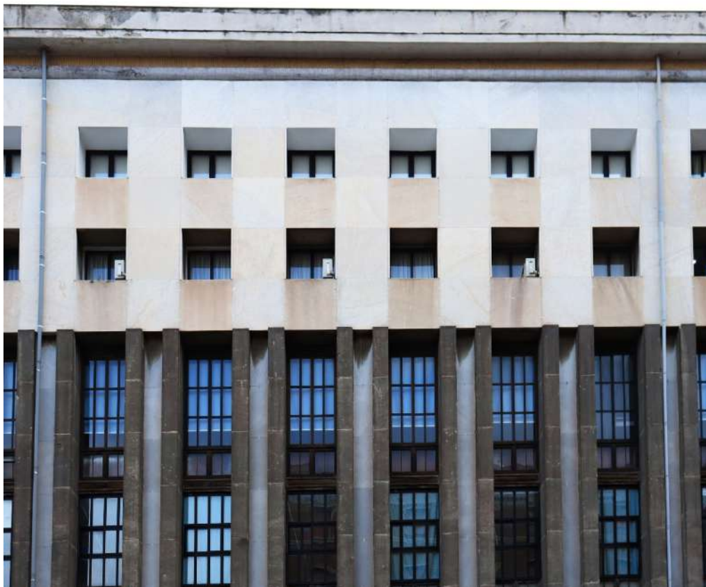
Figura 201- Effetti del dilavamento sul Prospetto della Casa del Mutilato del Rione Carità, a Napoli. Si evidenzia in particolare modo il pattern derivante dalle alterazioni cromatiche scaturite dal flusso dell'acqua sui prospetti. Foto di S. Iaccarino, Novembre 2021.
