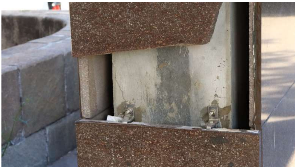
Figura 196- Palazzo delle Poste, A. Libera. Dissesto delle lastre in porfido violaceo di Predazzo del portico d'accesso (restauro del 2002 di S. Poretti). Foto di S. Iaccarino, Roma, Maggio 2021.
