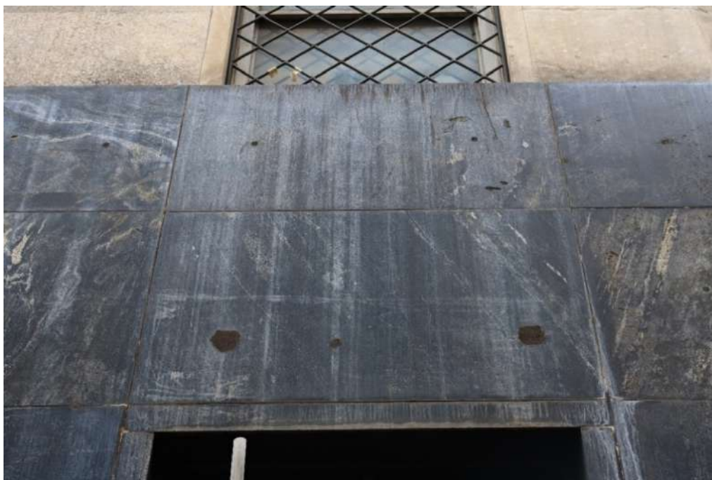
Figura 198- Tracce di interventi di consolidamento e ritenuta di alcune lastre del rivestimento in diorite del Palazzo Postale di Napoli. Si noti la discontinuità ricreata sulla lastra a seguito di tale intervento. Foto di S. Iaccarino, Novembre 2021.
