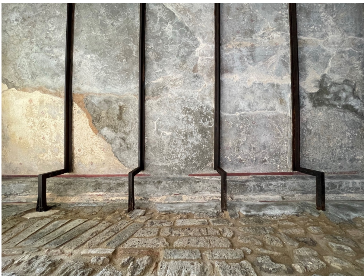
Gli elementi metallici inseriti a sostegno degli orizzontamenti della Villa di Diomede (ambiente 59-dicembre 2021)
