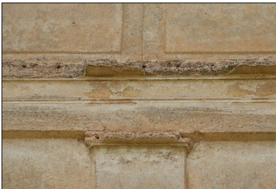
Fig. 89 – Pompei, Casa dei Capitelli Figurati, hortus/viridarium T: fori di alloggiamento di chiodi in corrispondenza degli elementi più sporgenti di cornici e lesene (foto dell'autore).
