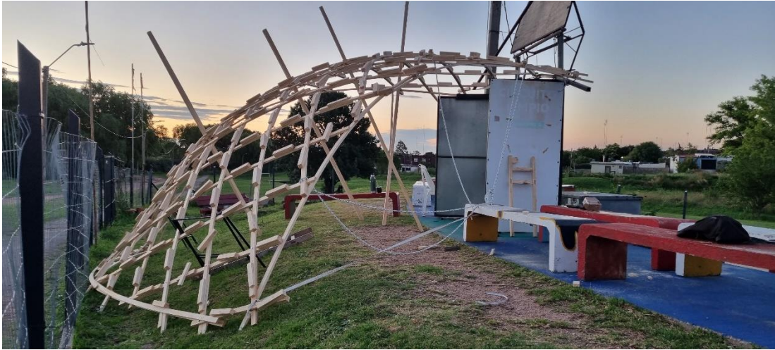
Fig. 70 struttura deformata con puntoni e cavi di ritegno
