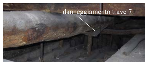
Fig. 3.5.7. Trave 7 con danneggiamento delle fibre inferiori.
