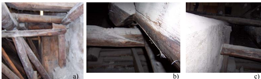
Fig. 3.3.12. Trave rompitratta B: a) Appoggio lato Piazza del Plebiscito; b) Giuntura a becco di flauto; c) Interruzione in corrispondenza della trave 11.
