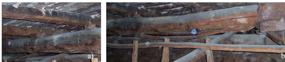
Fig. 3.4.5. a) Imbarcamento del solaio; b) Crisi della trave n.1.
