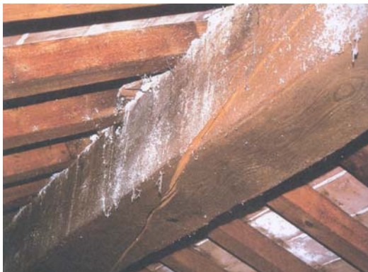
Fig. 2.1.1. Normale fenditura da ritiro trasformata in una vera e propria rottura della trave
