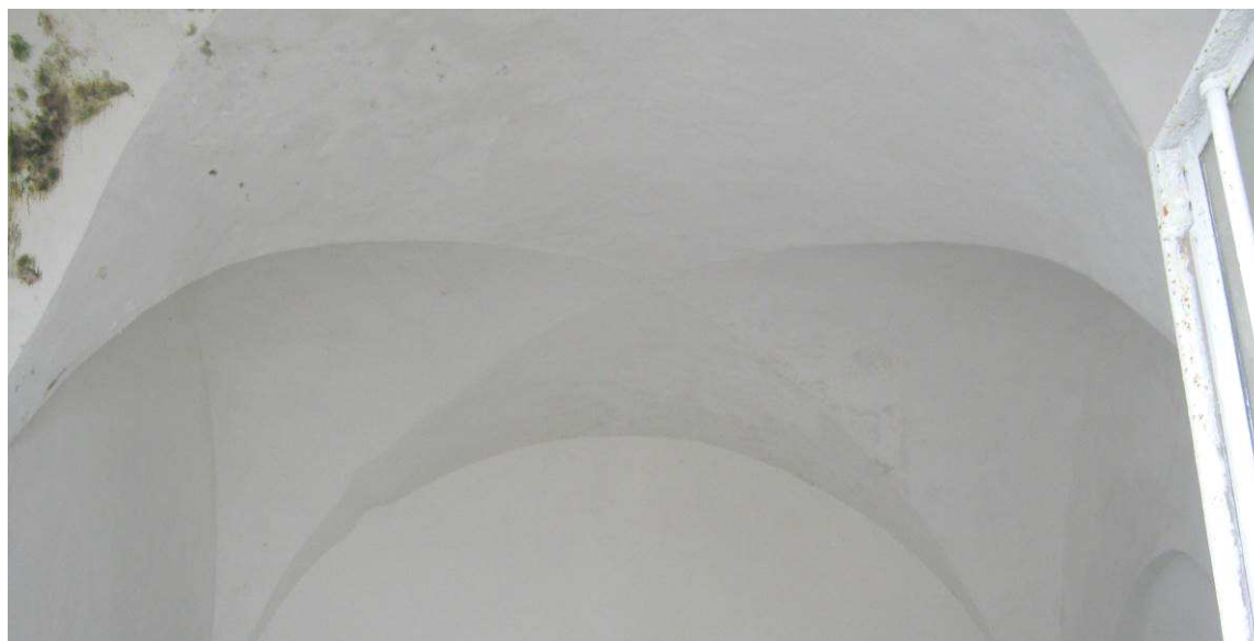
Figura 86 Le volte a crociera che sormontano la sala al lato della Chiesa. Evidente la continuità compositivo – costruttiva. Evidenti sono i segni di ammaloramento dovuti alla forte umidità (Foto F. Comes 2012)
