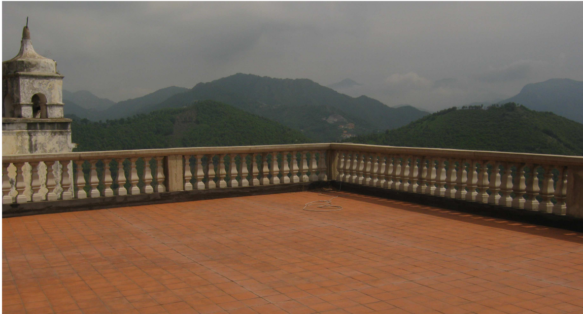
Figura 92 Il terrazzo che sormonta il secondo edificio. Evidente è la recente posa in opera di nuova pavimentazione e della guaina impermeabilizzante. Da sottolineare, infine, il bel parapetto fatto di colonnine sagomate e modanate (Foto F. Comes 2012)
