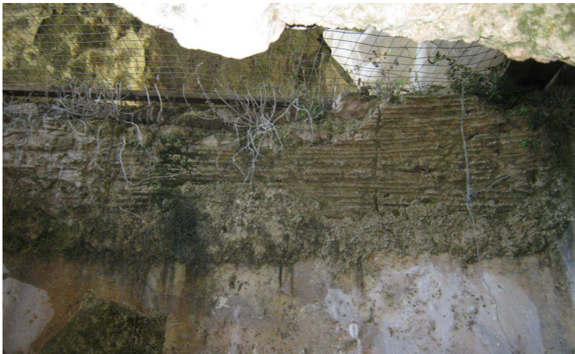
Figura 137 La struttura a volta che ricopre il locale a sud posto alla quota inferiore. Evidenti i segni della tecnica a incannucciata , ossia della realizzazione mediante una centina di cannuce, secondo la tipica tradizione costruttiva locale (Foto F. Comes 2013)
