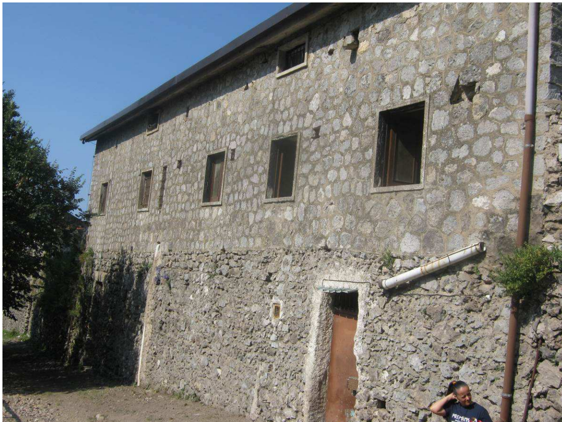
Figura 64 Il prospetto longitudinale della foresteria che dà verso l'esterno: evidente le differenti caratteristiche costruttive tra questa ed il muro di cinta su cui si innesta. Alla disordinata e caotica disposizione di irregolari conci di pietra nella parte inferiore, si oppone la regolarità costruttiva della parte superiore (Foto F. Comes 2012)
