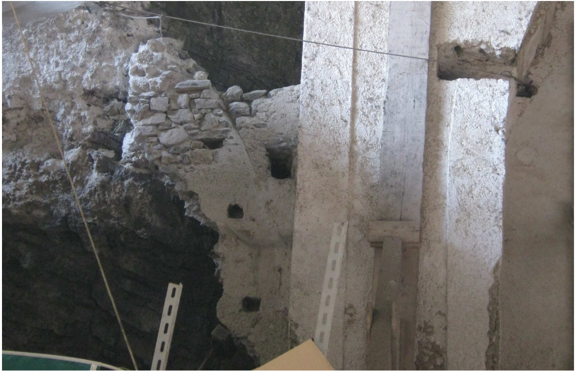
Figura 10 Il lacerto del secondo elemento arcuato. L'apparecchio murario, costituito da bozze di pietra calcarea ricavata in loco, si caratterizza per la disomogeneità delle pezzature, in cui prevale, comunque, la presenza di elementi orizzontali (Foto F. Comes 2013)
