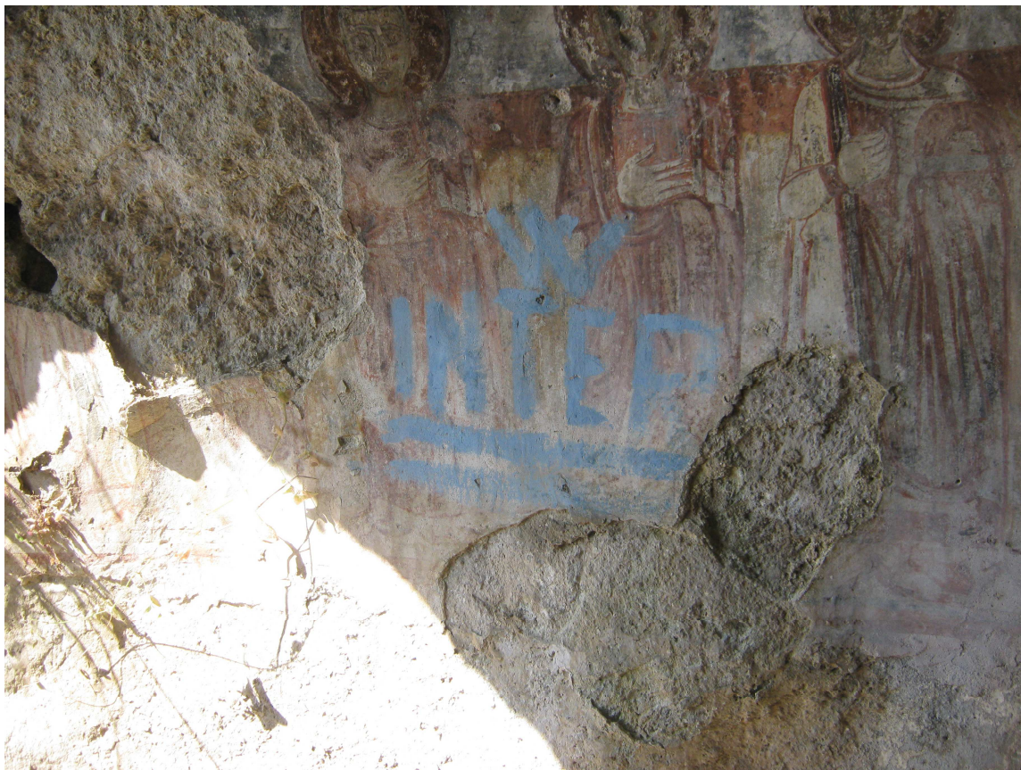
Figura 119 Le tre figure sul lato sinistro della Grotta: pur se meglio conservate rispetto alle altre nella parte superiore, risultano però fortemente danneggiate nella parte inferiore, a causa del distacco dell'intonaco in più punti e della vernice con cui è stata realizzata la scritta (Foto F. Comes 2013)
