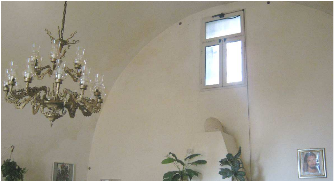
Figura 70 Il refettorio posto al piano inferiore del romitorio. Evidente è la presenza di alcuni fenomeni di macchie e scoloritura della pellicola pittorica (Foto F. Comes 2012)
