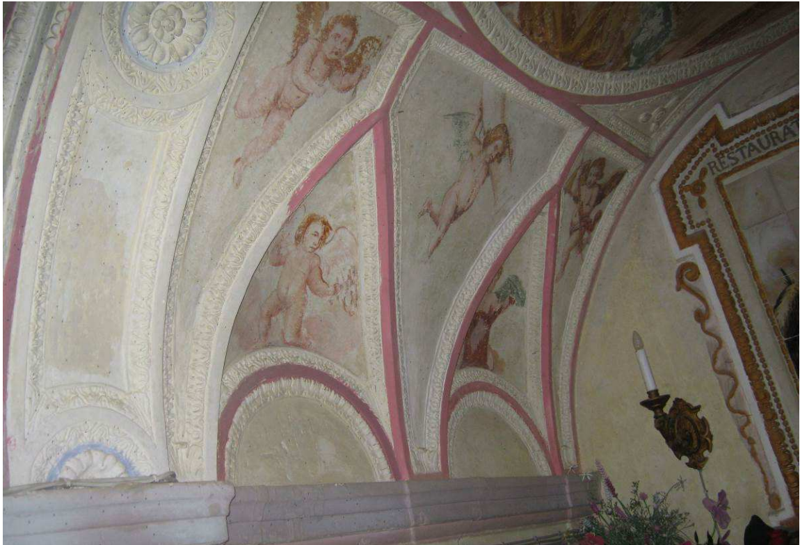
Figura 52 Le lunette ed i riquadri che accolgono la rappresentazione dei dieci angeli. Evidenti, da questa immagine, le principali forme di degrado legate alla forte umidità del luogo, solo in parte tamponate dalla "gabbia" di metallo che racchiude la cappella. Da sottolineare, inoltre, la presenza dei cavi relativi all'impianto elettrico che corrono lungo il perimetro interno della cappelletta (Foto F. Comes 2012)
