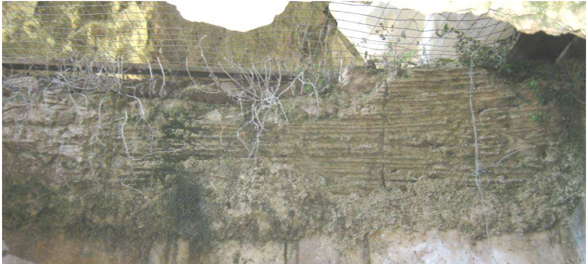
Figura 18 L'Eremitico di Santa Barbara in Ravello. La struttura a volta che ricopre il locale a sud posto alla quota inferiore. Evidenti i segni della tecnica a incannucciata . (Foto F. Comes 2012)
