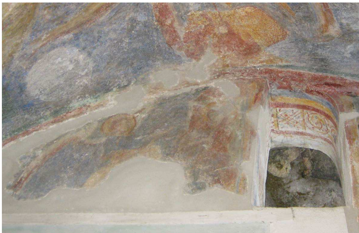
Figura 10 L'Annunciazione, particolare. La parte inferiore dell'affresco è andata persa in seguito all'allargamento della finestra inferiore (Foto F. Comes 2011)
